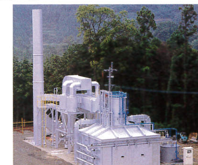
建築廃材焼却炉
