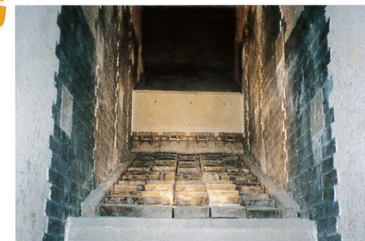
焼却炉内燃焼ストーカ
